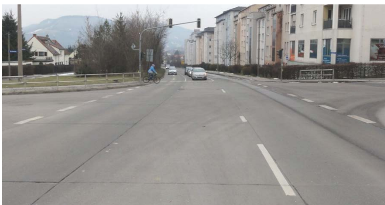
Foto: Betonfahrbahn mit regelmäßigen Längs- und Querfugen (Knotenpunkt Winzerlaer Straße/ F.-Zucker-Straße/ Buchenweg)
