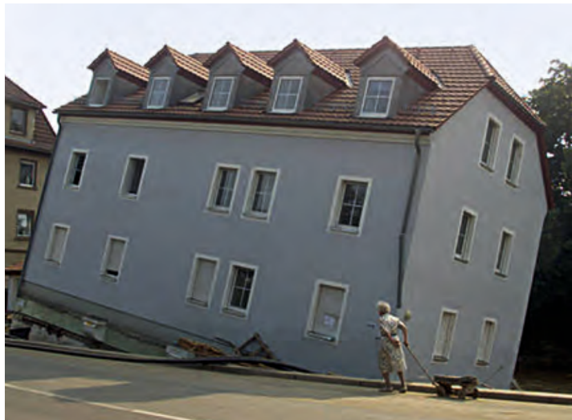
Unterspültes Haus an der Weißeritz
